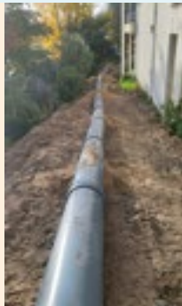
Canalisation provisoire aérienne
