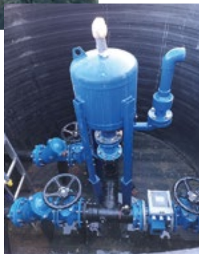
Poste de refoulement Audubon (ZAC Doulon-Gohards)
